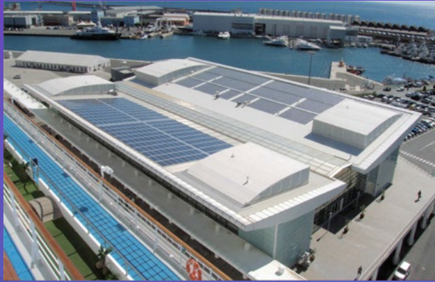
Impianto fotovoltaico sul tetto del Palacrociere Potenza installata 121 kW (87 kW policristallino - 34 kW amorfo)
